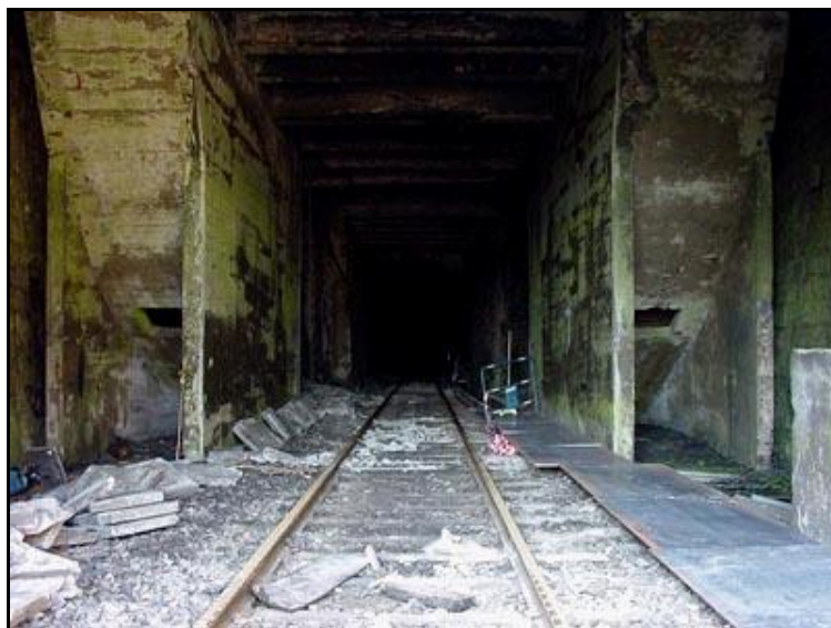
Belle photo montrant la sortie du tunnel avec les deux gaines d'aération latérales en béton armé
