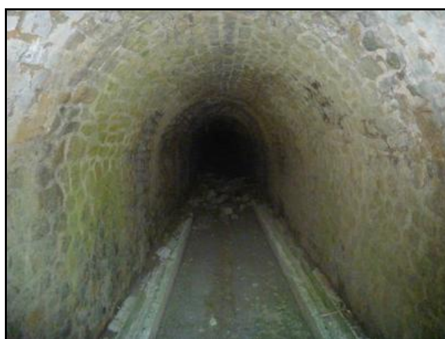
Eboulement de piédroit
