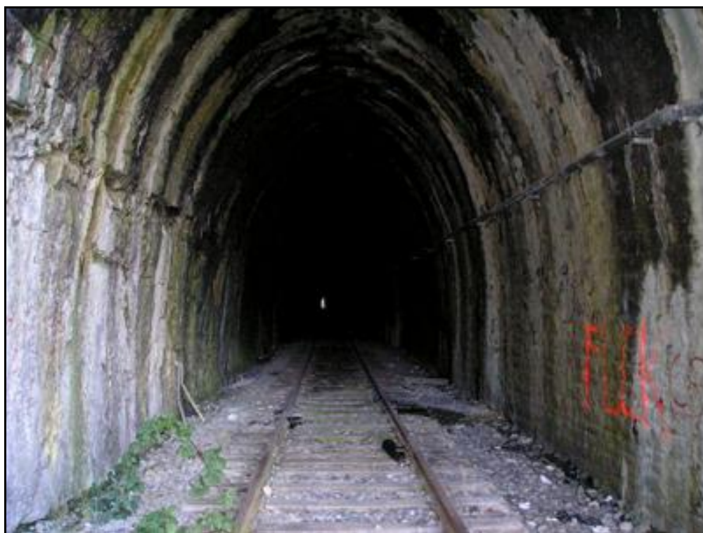
Et le tunnel dans son état ancien, tel qu'il apparaissait avant travaux
