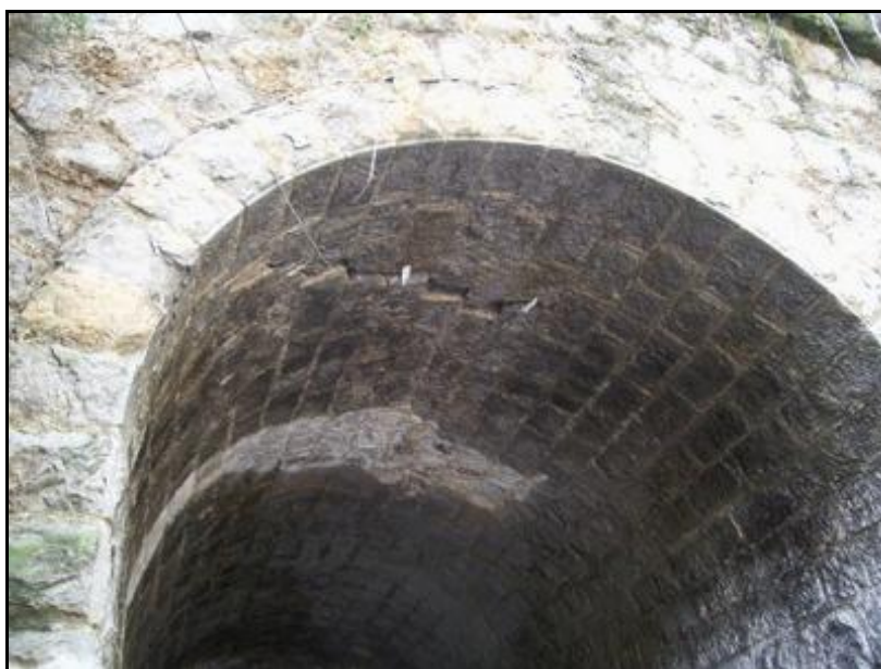
Fissuration importante due à la décompression du terrain et tendant à décoller le fronton d'entrée du tunnel du reste de la voûte
