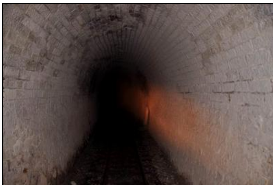
La galerie telle qu'elle peut être vue depuis une cabine de conduite
