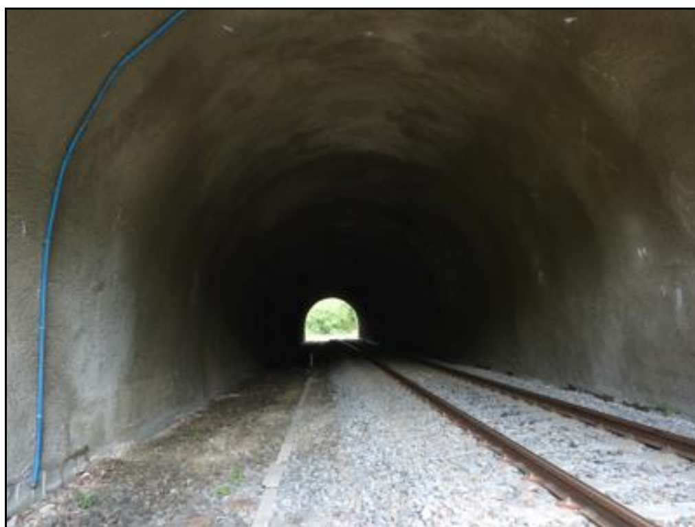
La galerie du tunnel en regardant vers l'entrée Le tuyau bleu sert à dévier une infiltration d'eau en voûte
