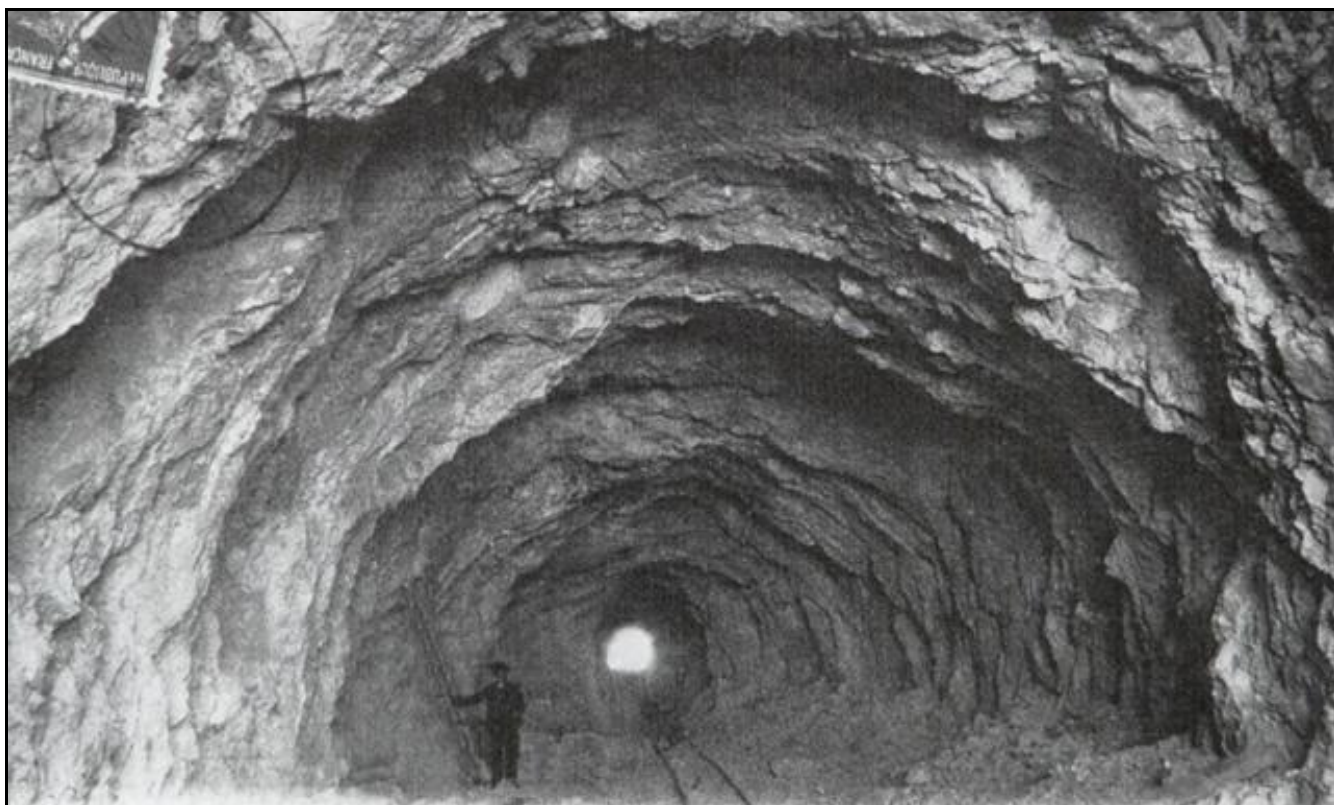
La galerie du tunnel du Moulon en cours de creusement Notez dans le fond la section réduite de la galerie d'axe exploratoire creusée en reconnaissance
