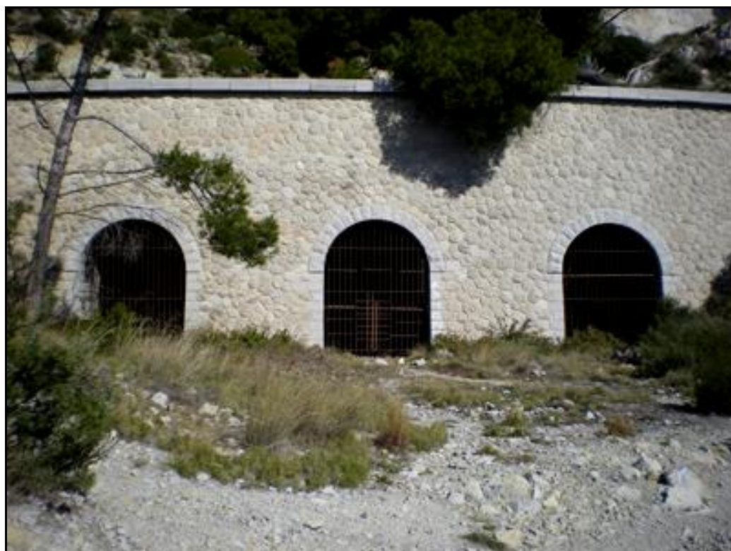
Jolie photo des fenêtres grillagées de la galerie de protection qui relie entre eux les tunnels des Pierres Tombées et des Glaieuls
