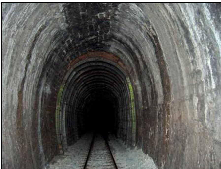
L'intérieur de la galerie avant les travaux de remise en état Les cintres métalliques sont ici bien visibles
