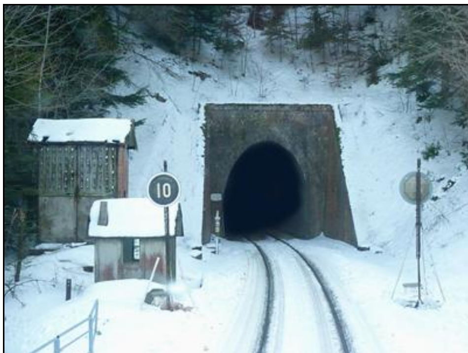
L'entrée du tunnel en hiver avec limitation de vitesse à 10 km/h en raison de coulées de glace dans la galerie
