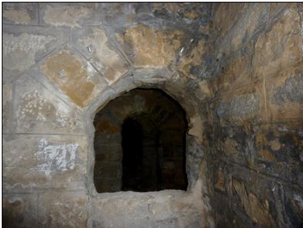
Gros plan du passage vers l'extrados du piédroit Les contreforts sont visibles à l'arrière-plan
