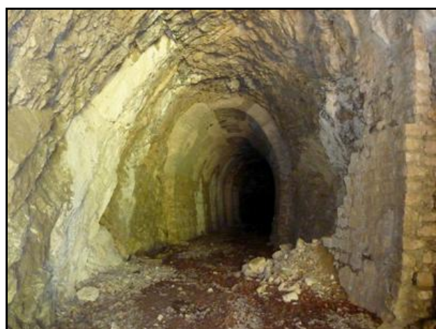
Piédroit effondré près de la sortie
