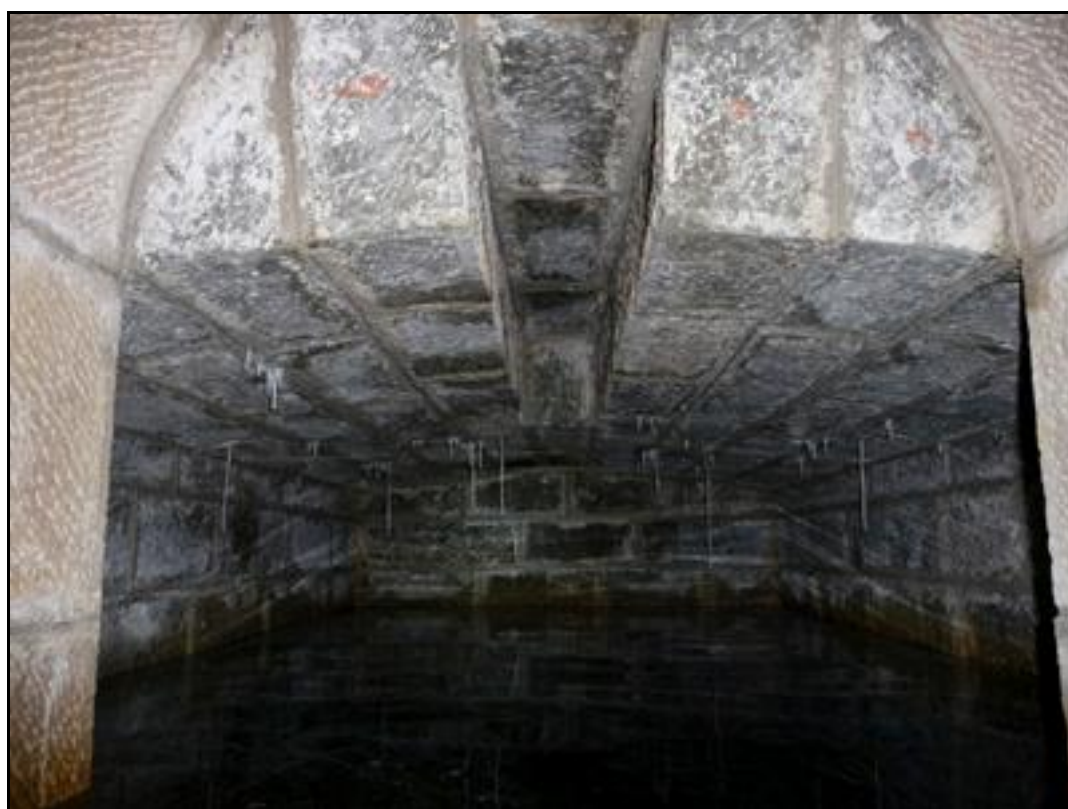
Le fourneau de ciel, partiellement noyé par les eaux d'infiltrations Un écoulement était prévu, mais s'est bouché faute d'entretien
