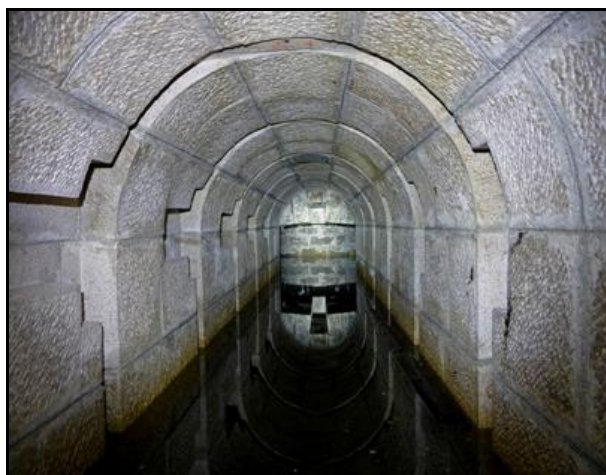
La galerie basse du fourneau de ciel, inondée
