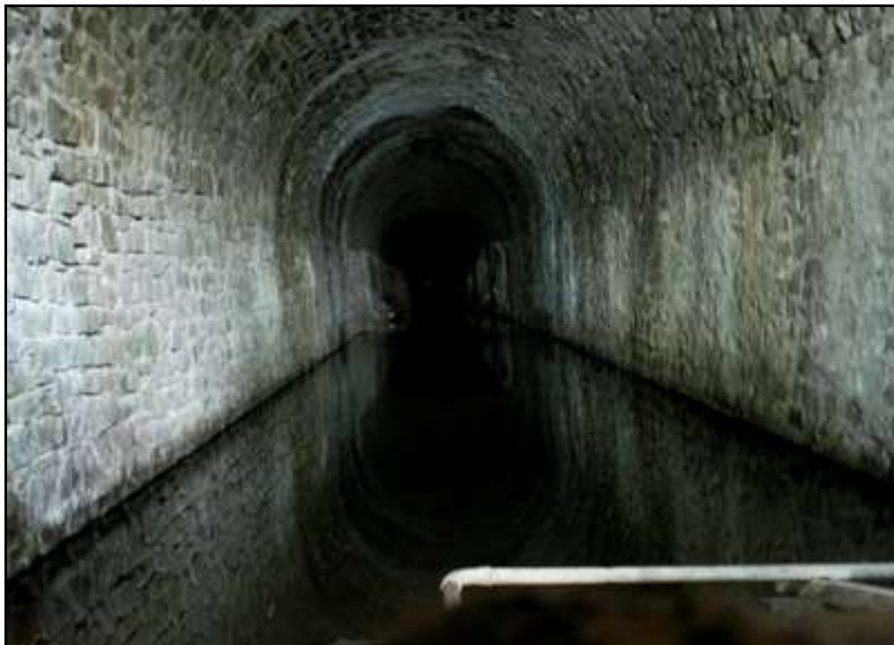
La galerie transformée en réservoir d'eau et les stross latéraux bien visibles qui témoignent de son inachèvement
