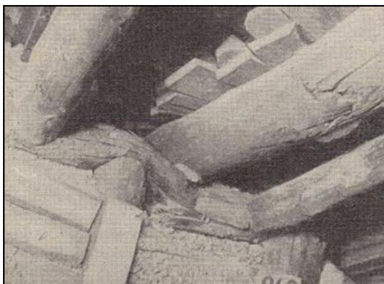
Ecrasement et rupture des boisages des travaux
