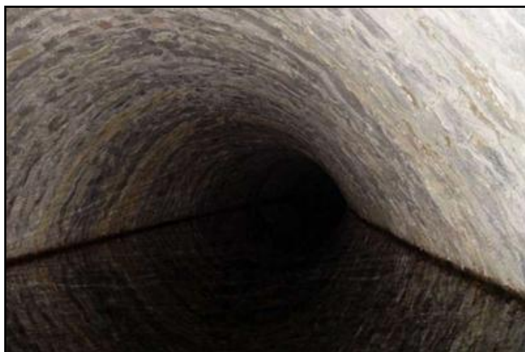
La belle galerie du tunnel, hélas souvent noyée par les eaux
