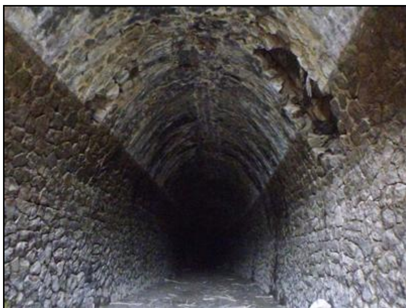
Les eaux du lac rongent le ciment des parements. Ce qui explique que ces derniers donnent quelques signes de faiblesse
