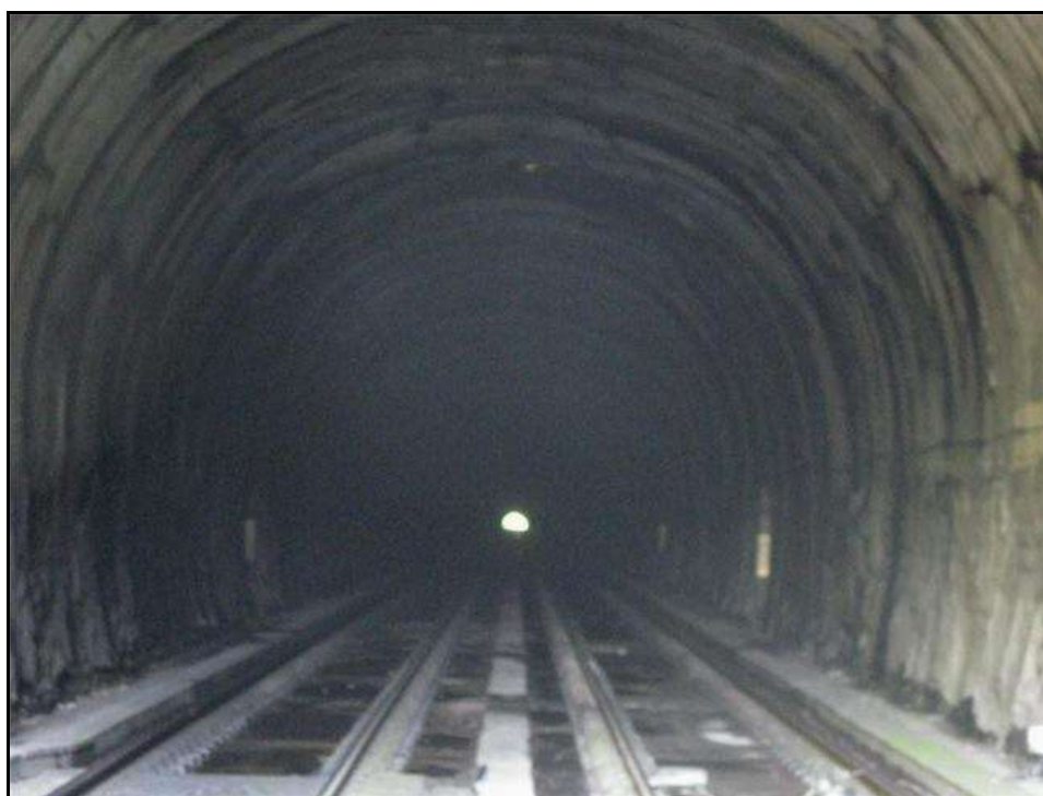
Ci-contre, la galerie avec la dalle en béton qui recouvre son radier
