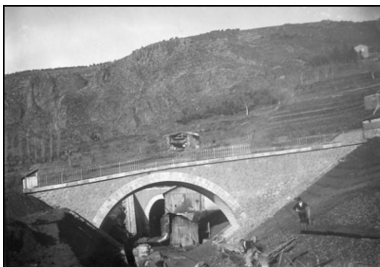
L'entrée du tunnel avec un baraquement de chantier dans la tranchée d'accès
