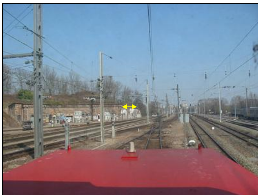
Vue côté sortie de l'ancienne galerie, il ne reste en place que le piédroit ouest (flèche jaune)
