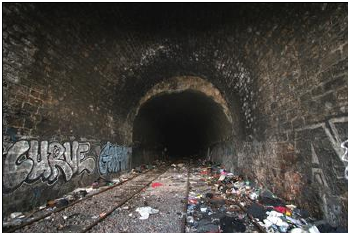
Demier raccord de voûte entre l'ancien tunnel du Sorbier à l'arrière-plan et le fronton de sortie actuel du tunnel de Charonne
