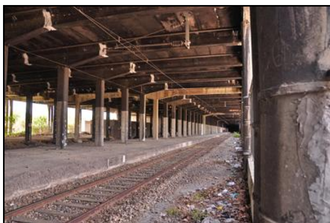
La « gare souterraine » avec son quai central
