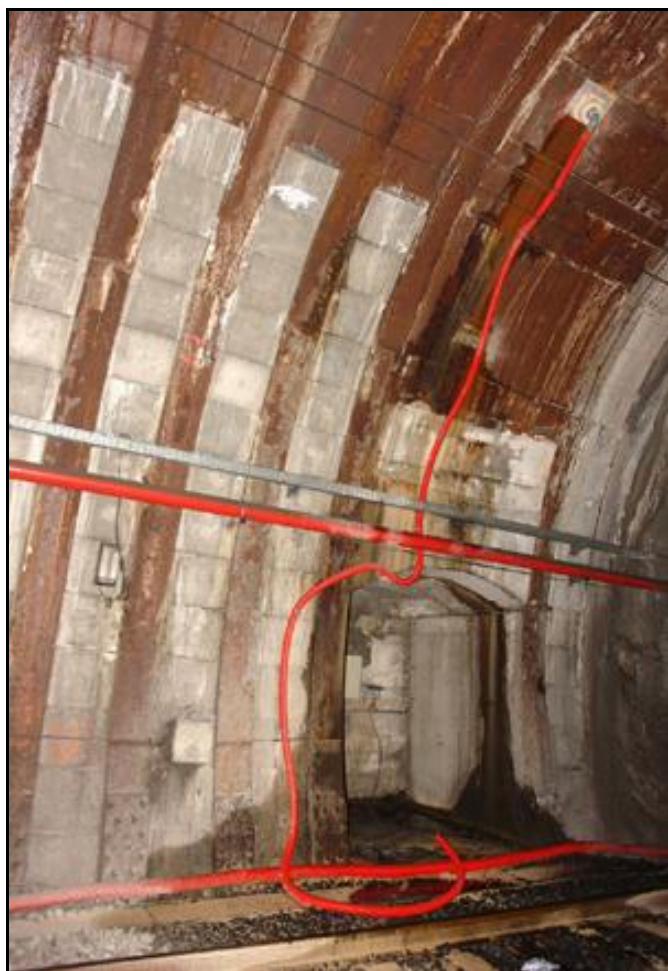
Captage des arrivées d'eau par conduites souples Les cintres et le chemisage métalliques sont bien visibles
