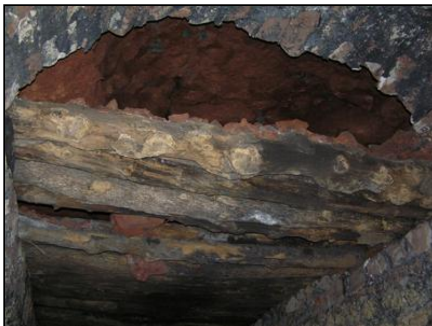
Deuxième platelage de rondins avec des blocs de pierre qui ne demandent qu'à tomber
