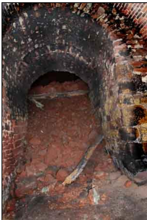
Ci-dessus, le sommet du grand éboulis, dans la cloche d'effondrement, 5 m au-dessus du radier
