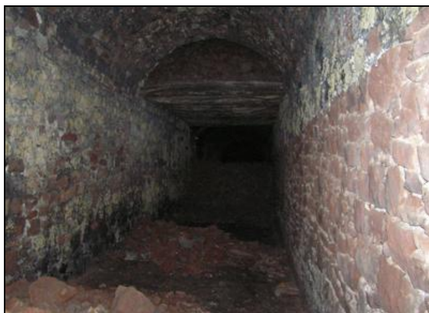
Troisième platelage de protection avec, dans le fond, une importante coulée de pierres sur toute la largeur du radier
