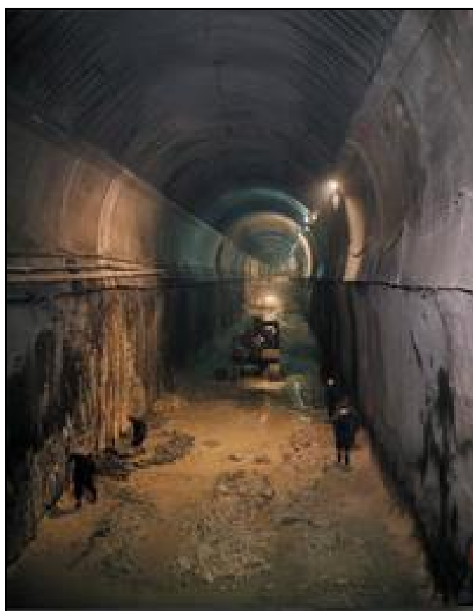
Abaissement du radier La voûte de l'ancien tunnel est nettement visible dans la partie haute de l'excavation
