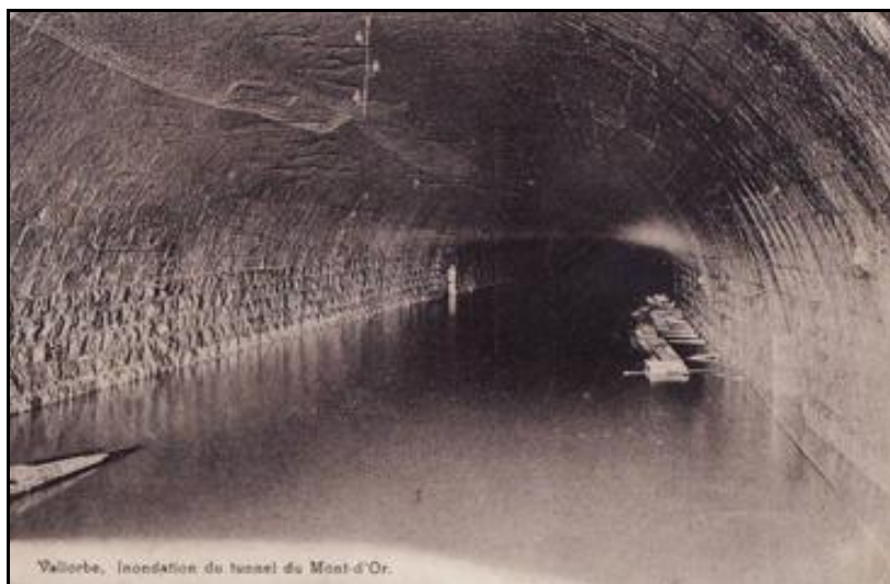
Le tunnel transformé en lac souterrain
