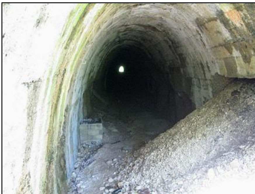
Le lâchage de piédroit proche de la sortie
