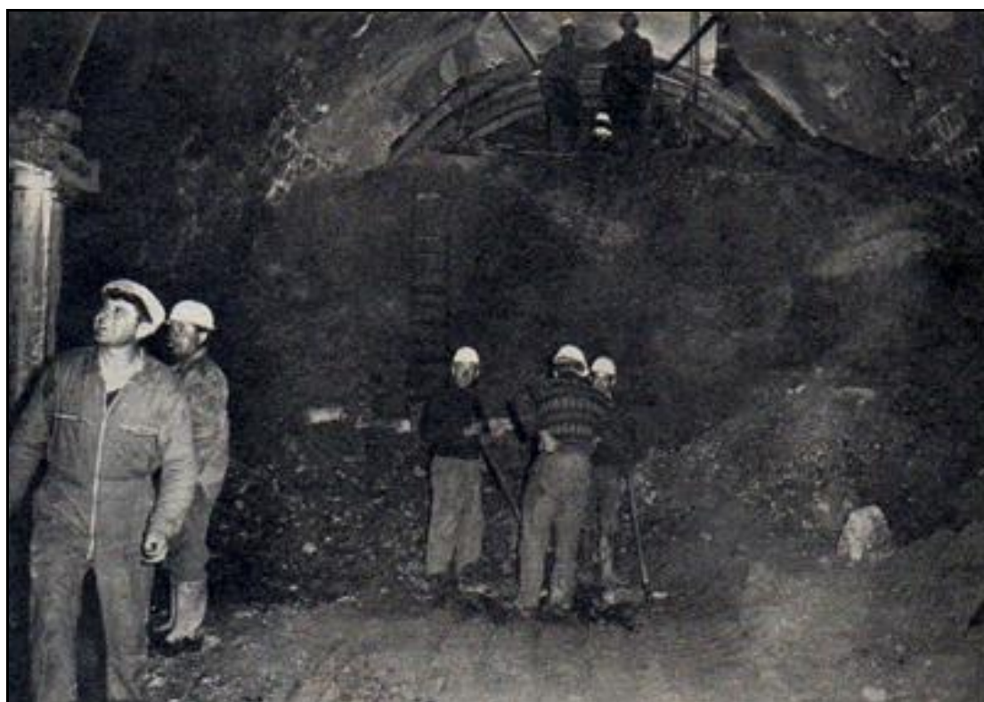
Intrusions dans le tunnel par le nord Les cintres métalliques sont clairement visibles
