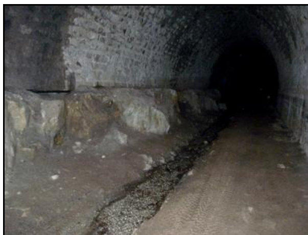
Un stross, à gauche Cette photo montre bien que la base gauche de la voûte n'a pas d'assise
