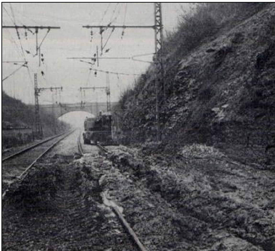
Déblaiement des voies Notez l'épaisseur de la coulée de boue
