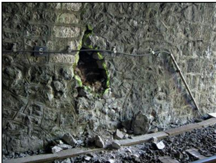
Lâchage de piédroit près de la sortie
