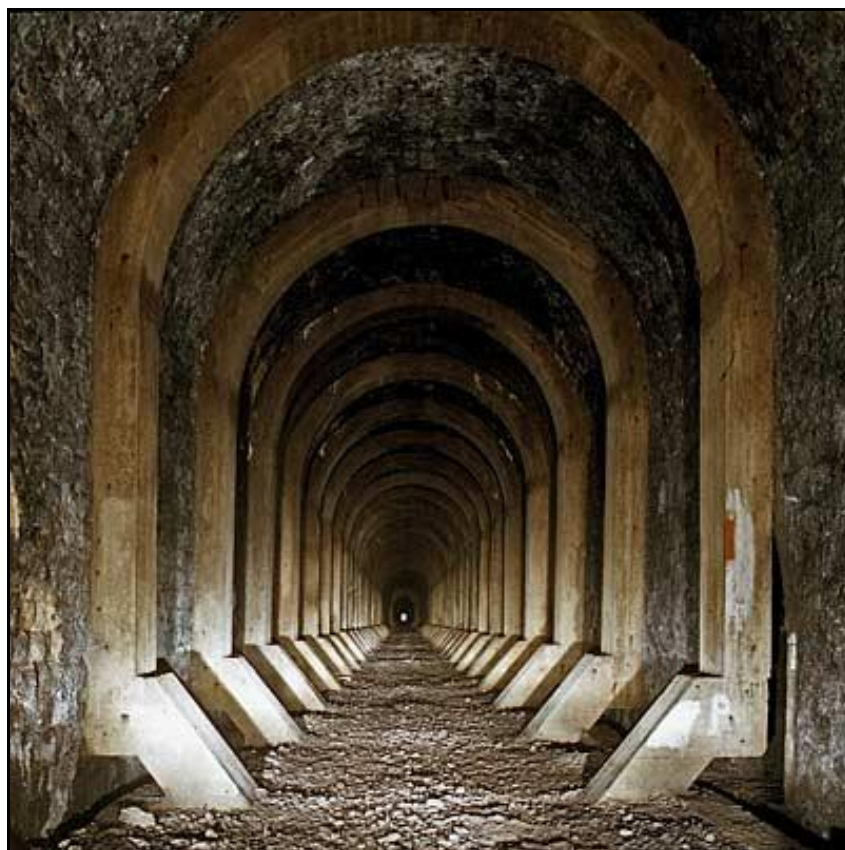
L'ancien tunnel renforcé par des arceaux en béton construits après son déferrement
