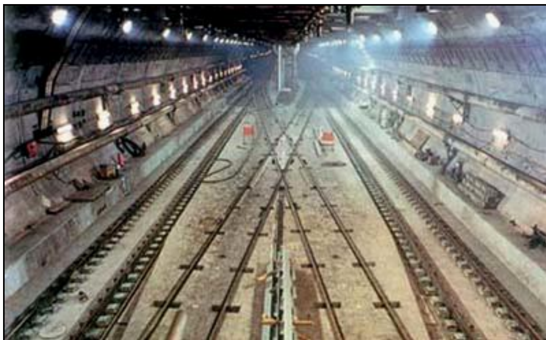
Cross-over souterrain Les portes coulissantes de sécurité sont ici ouvertes et laissent voir les voies de liaison ferroviaires entre les deux galeries
