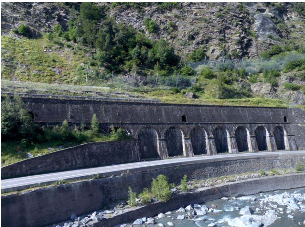
Vue de la galerie de protection qui fait suite au tunnel percé en juillet 2023
