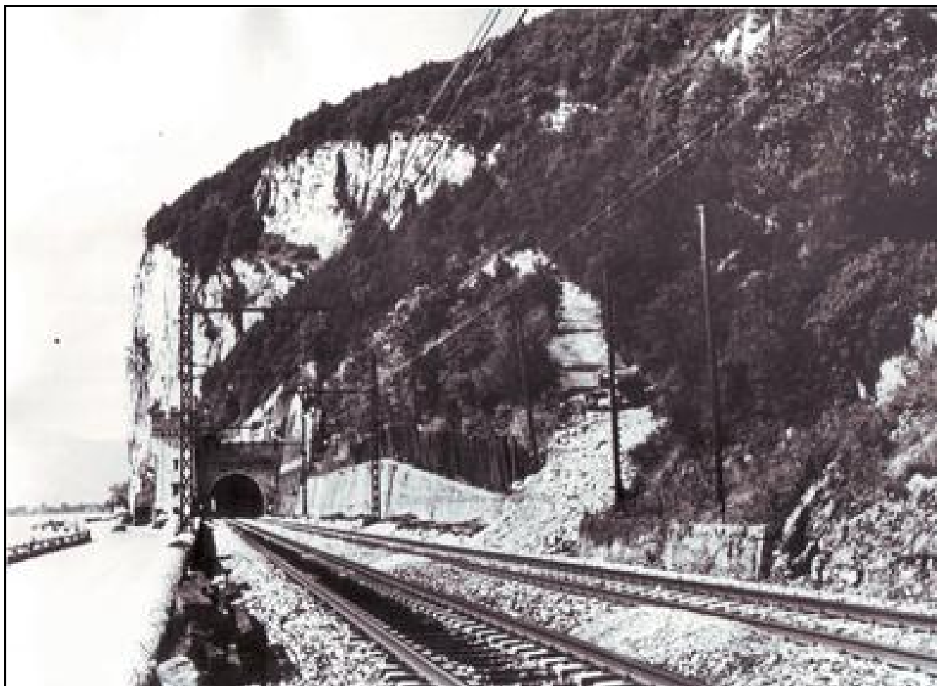
Travaux préparatoires et réalisation de la piste d'accès au front de minage
